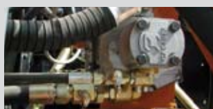
Impianto idraulico ad alta potenza
